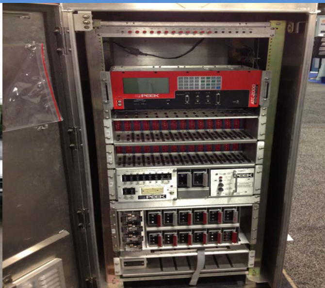
Gabinete 332 Comum (CALTRANS) e gabinete ITS
