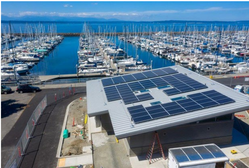
Paneles solares en el Puerto de Seattle (fuente de la imagen: Puerto de Seattle)
